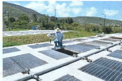
Imagen 2. Planta de tratamiento (lodos activados) del municipio de Unión de Tula.
