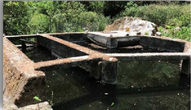
Imagen 3. Sistema de abastecimiento de agua potable, municipio de Tolimán.
