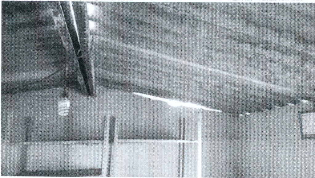
Imagen3.- Malas condiciones de la barda y techo del área de trabajo del grupo de mujeres, es necesario la rehabilitación de toda la infraestructura del techo.
