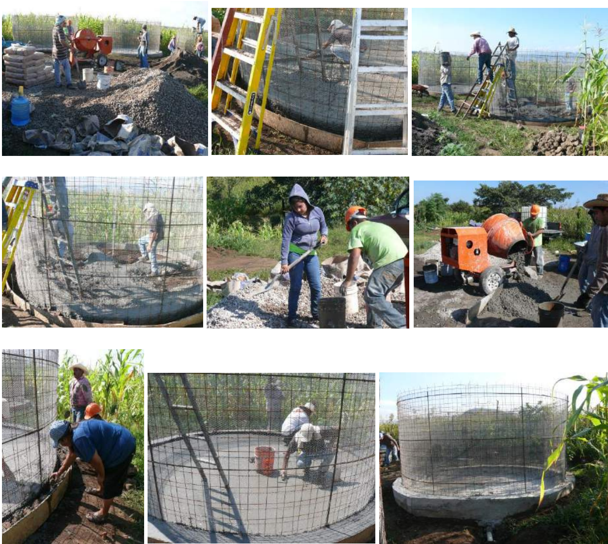
Tanques de ferrocemento.
