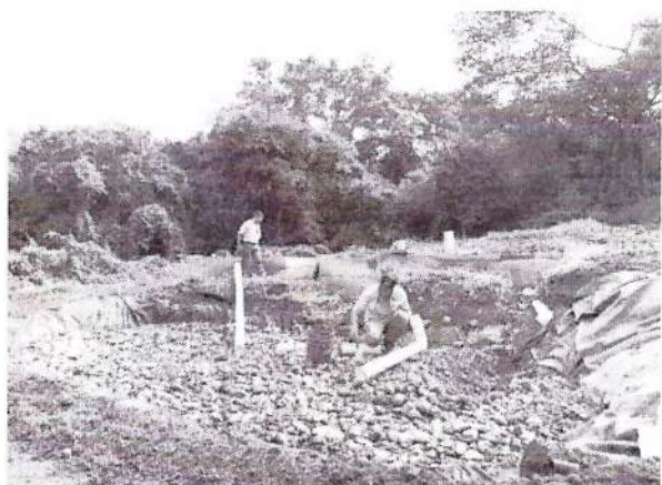
Medición y acomodo de tubería para la conexión de los humedales al sistema de tratamiento.
